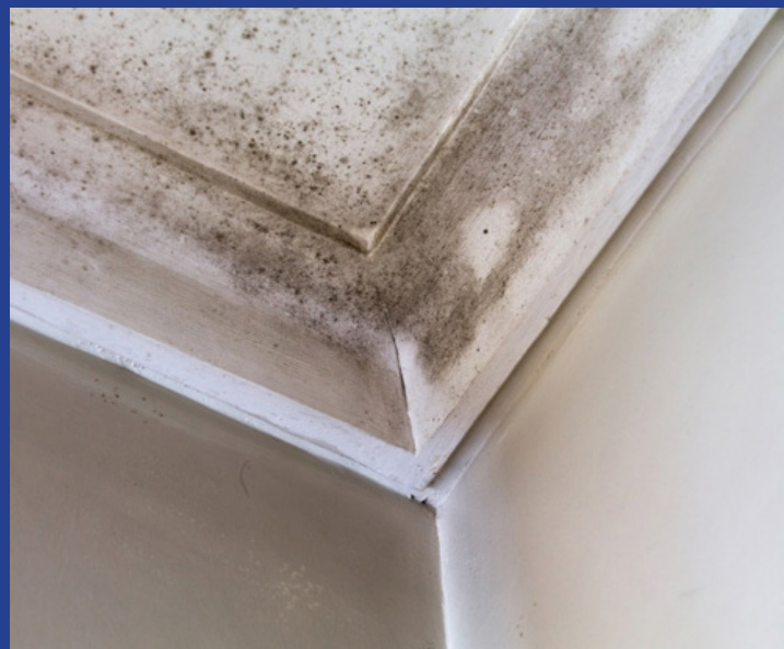
Figura 1 – Tecto com manchas de bolor
